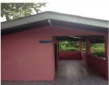
ส้วม สปข.601/26 ปีที่สร้าง 2541
